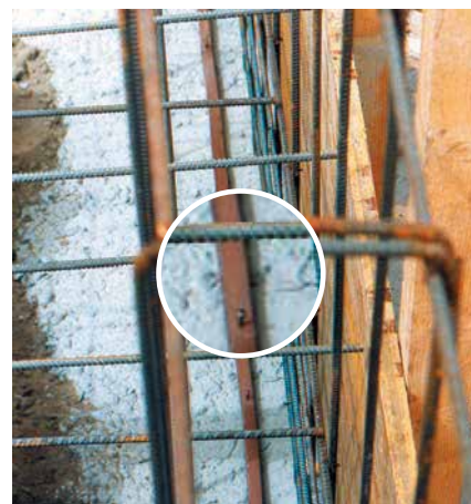
Particolare del posizionamento del giunto bentonitico sandtex gr 20 fissato meccanicamente in corrispondenza di tutte le riprese di getto
