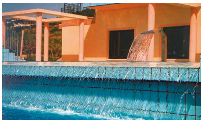
La cascata alimentata dallo sfioro della vasca superiore, mette in evidenza la struttura verticale di separazione delle due vasche, impermeabilizzate da ambo i lati con VANDEX BB 75
