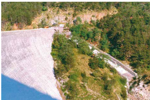
Veduta d'insieme del canale scolmatore della diga oggetto dell'intervento di ripristino ed impermeabilizzazione
