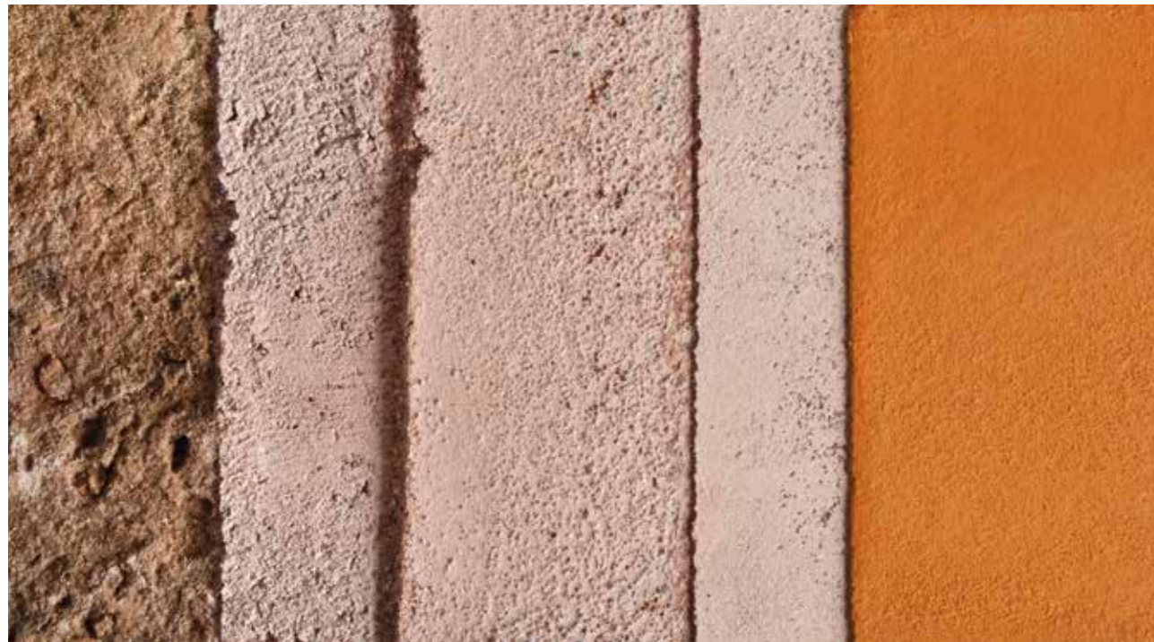
Stratigrafia di facciata composta da: struttura in pietra, rinforzo in sandtex malta grezza con l'additivazione della polvere di cocciopesto , strato di malta grezza additivata con il cocciopesto , malta fine additivata con il cocciopesto , finitura sandtex antiqua 1 .
